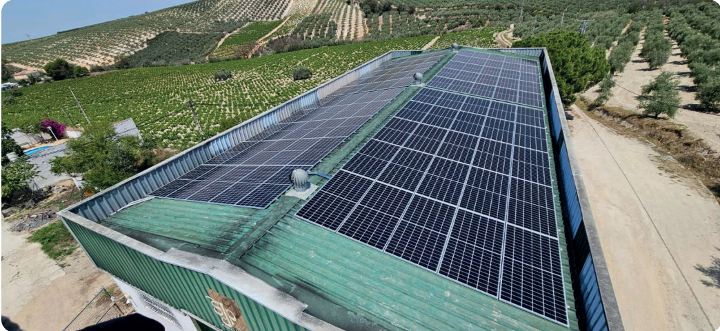
Planta solar de autoconsumo en la cubierta de una de las naves de Lagar Los Raigones
